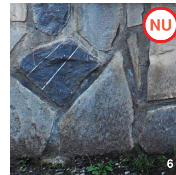
ASA NU: Placare a soclurilor realizată pe scară largă în zonă, care nu se încadrează în specificul local.
